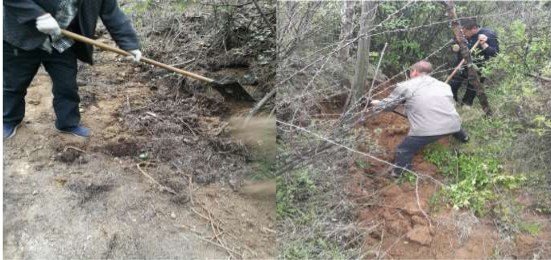
裂缝整治前后对照图
