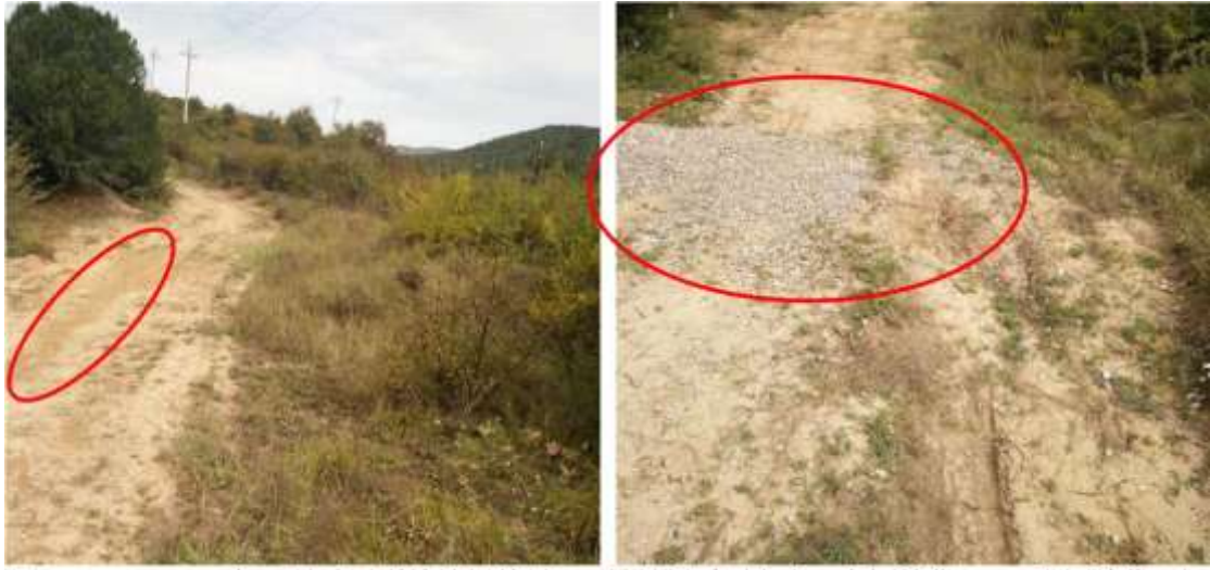
裂缝整治前后对照图
